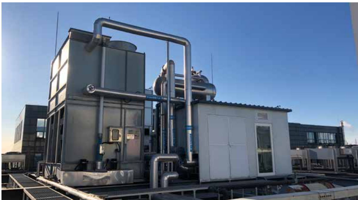
体育总局彩票中心数据中心节能空调
